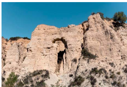
Foto 9. Vista de los fenómenos de tubificación sobre los terrenos detríticos de la rambla de Puça.
