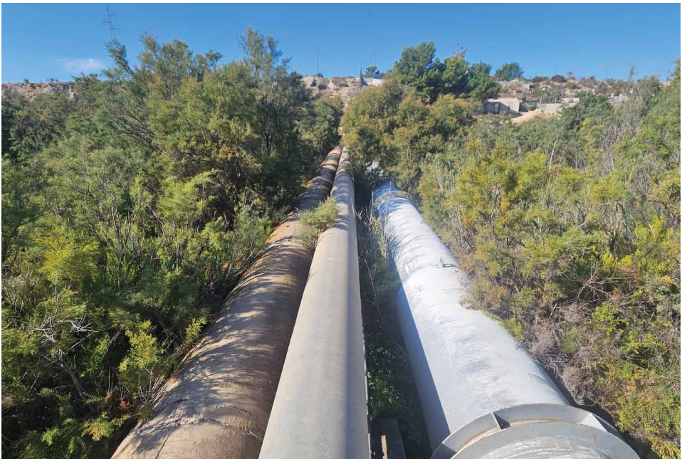
Figura 23. Fotografía de las tuberías de la red de canales del Taibilla a su paso por Elche.
