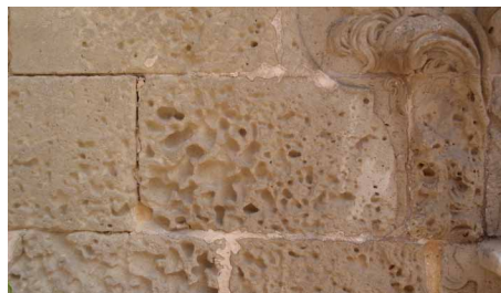
figura 24 - Detalle del proceso de alveolización que sufren las rocas de la fachada de la iglesia de Santa María. Compárese con la figura 18.
